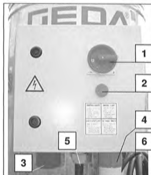
Obr. 19 Skříňový rozvaděč kabelového zásobníku
